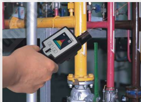
Detección de fugas a distancia con el puntero láser integrado
